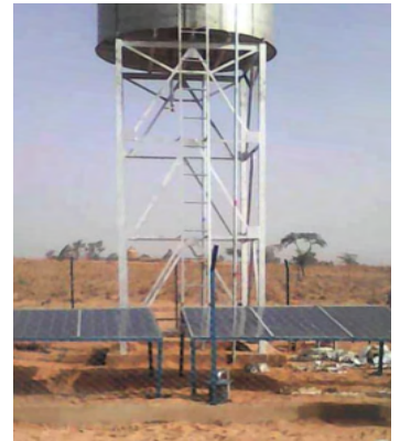
태양광 패널을 설치한 급수타워
